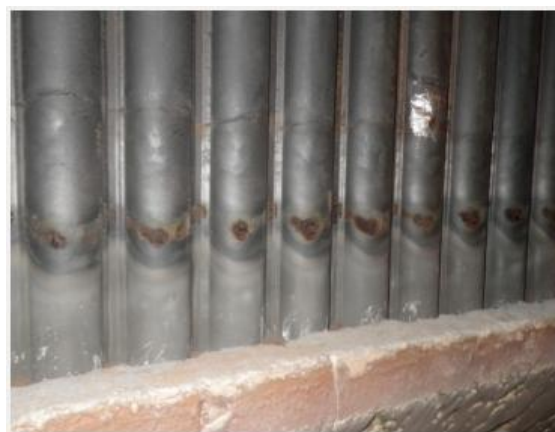
写真1 水冷壁パネルの損耗状況
