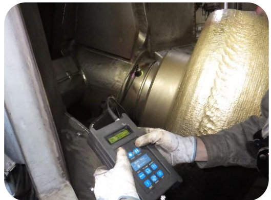
ベアリング診断の状況
